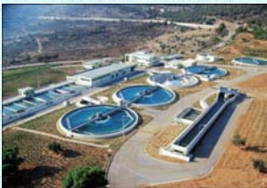
Μονάδα Επεξεργασίας Νερού Ασπροπύργου
