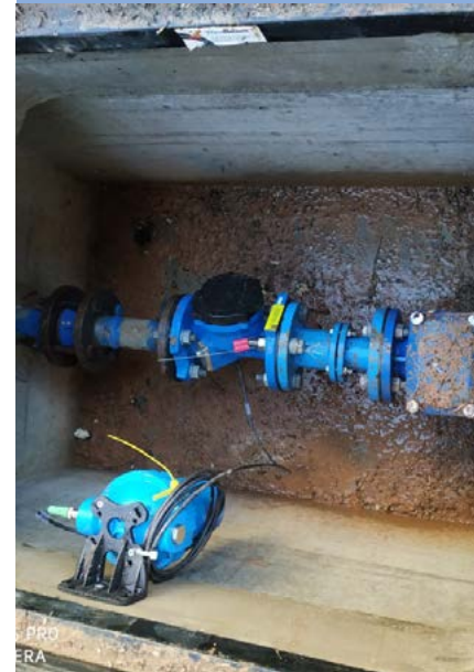
Φρεάτιο υδρομετρητή νέου τύπου
