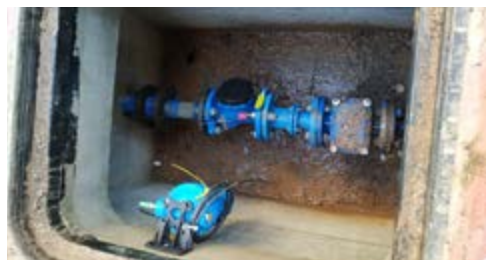
Φρεάτιο υδρομετρητή νέου τύπου
