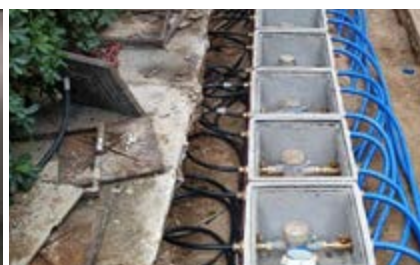
Σύστημα φρεατίων υδρομετρητών νέου τύπου
