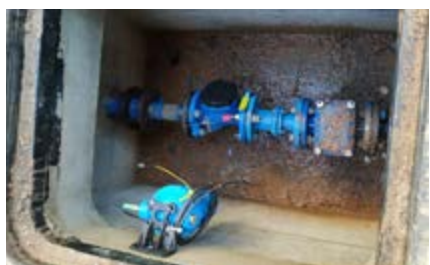
Φρεάτιο υδρομετρητή νέου τύπου
